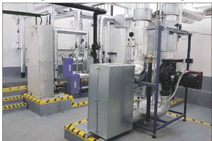
Zrekonštruovaná centrálna odovzdávacia stanica tepla
