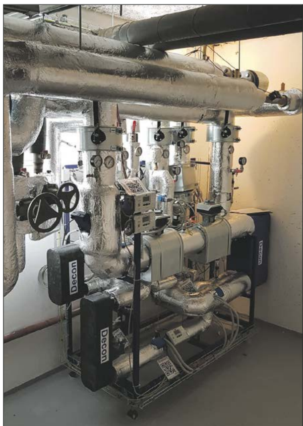
Kompaktná domová odovzdávacia stanica tepla (DOST)
