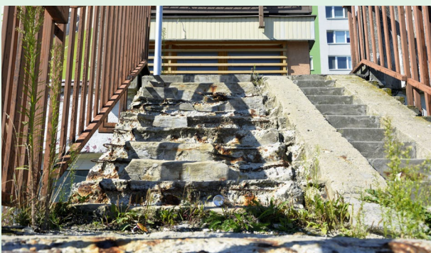
▲ Nepoužiteľné schodisko na Beňadickej
