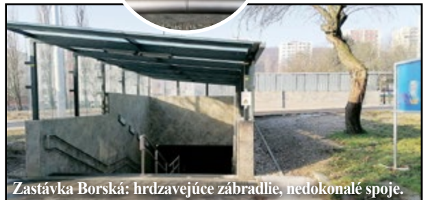
Zastávka Borská: hrdzavejúce zábradlie, nedokonalé spoje.
