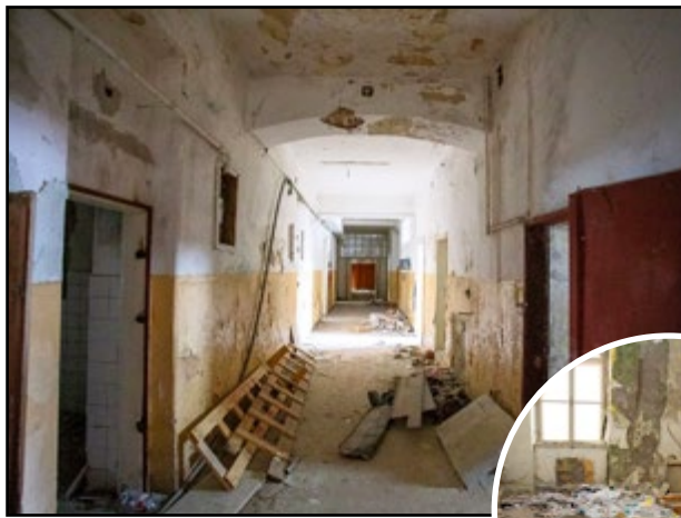
Vlhké steny, popraskaná omietka, nebezpečné stropy
