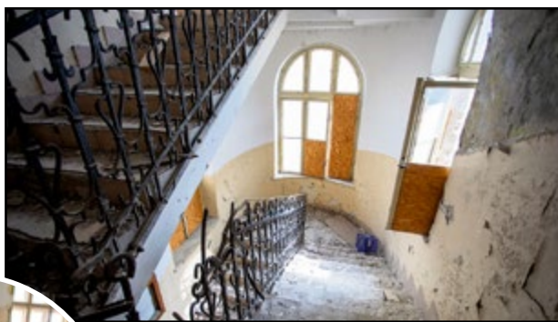
Zničené je aj historické zábradlie.
