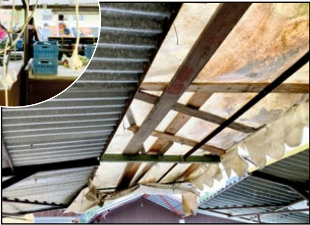
Zaplátaná strecha, provizórna elektroinštalácia... Ak má trhovisko prežiť, potrebuje komplexnú rekonštrukciu.
