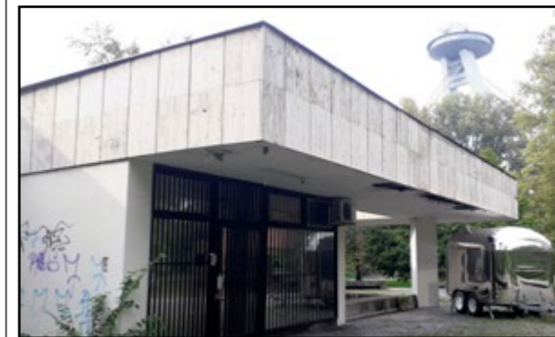
Budova bola v 90. rokoch neodborne zrekonštruovaná a mnohé prvky sa znehodnotili.
