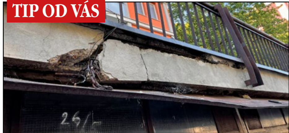
Časť stropu nad garážami sa rozpadáva, „fixuje“ ho kovová reťaz.
