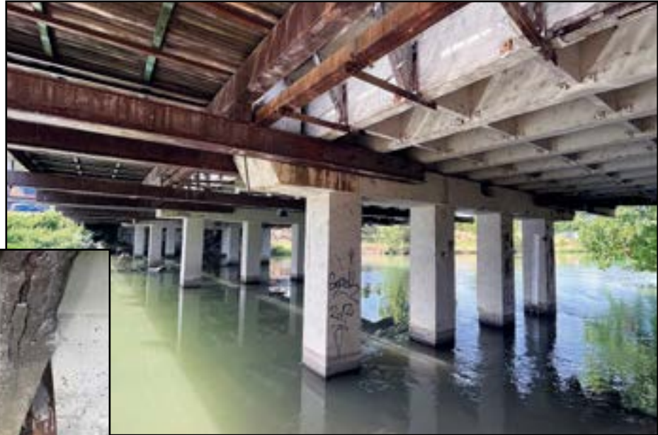
Most je v dezolátnom stave. Termín ukončenia prác je december 2025, mesto však plánuje spraviť všetko pre to, aby boli práce ukončené skôr.
