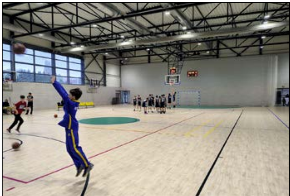
Športová hala má inštalované výkonné zariadenia pre vzduchotechniku a rekuperáciu, v zázemí je podlahové kúrenie.
